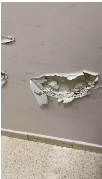
Figura 9: Grieta en pared
