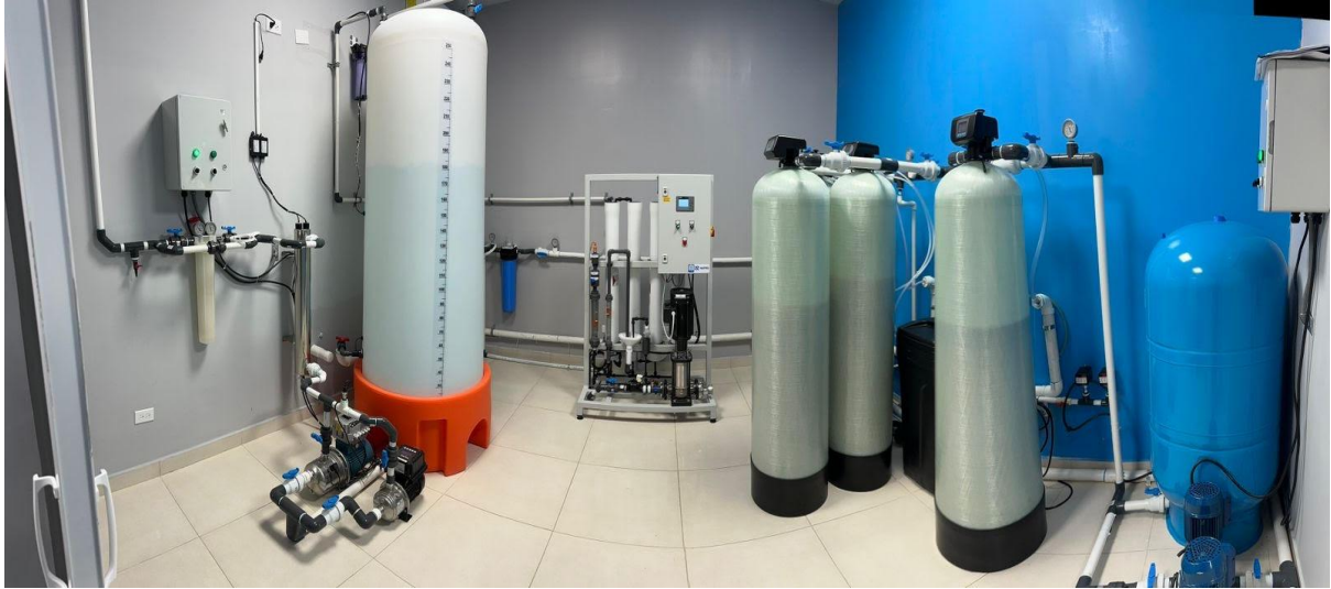
Anexo 3. Planta de ósmosis #2 del Centro de Asistencia Renal Río Hato.
