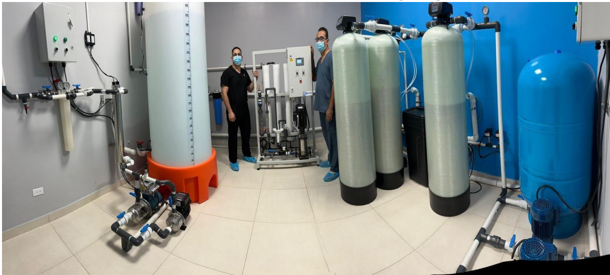
Anexo 4. Sanitización del anillo de distribución con el Ing. Rogelio Solís.
